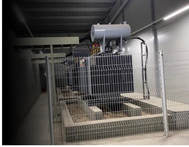
Şekil 1. Kapalı odadaki yağlı tip trafo (Kaynak : Ezgil)
